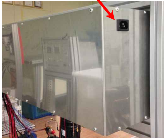
N.F.B 설치된 제어판 뒷면
