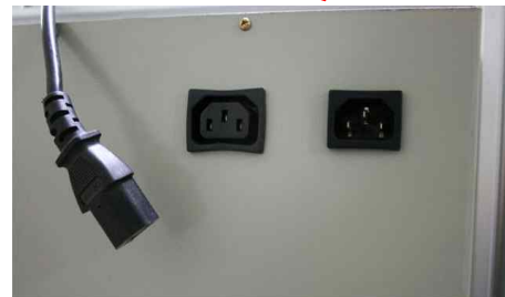
N.F.B 설치된 제어판 뒷면
