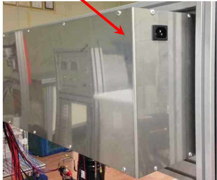
N.F.B 설치된 제어판 뒷면
